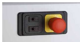
Módulo de alimentación Botón de parada de emergencia
